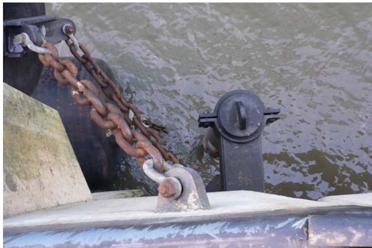
Abb. 12: Ungesicherter Pfahlkopf (Draufsicht)
