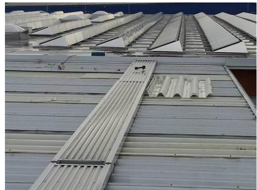
Abb. 10: Wartungssteg auf Hallendach
