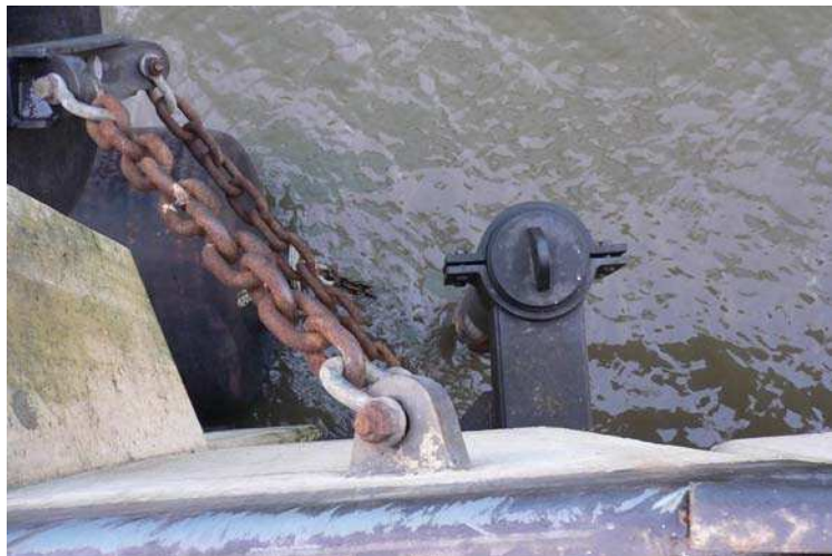
Abb. 12: Ungesicherter Pfahlkopf (Draufsicht)
