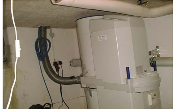
Abb. 16: Absauganlage im Keller
