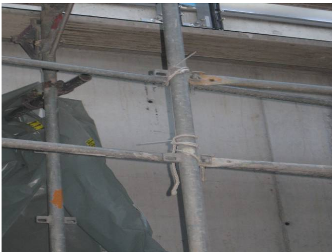
Abb. 22: Eine Verbindungsart, die der Gerüthersteller so nicht vorgesehen hat
