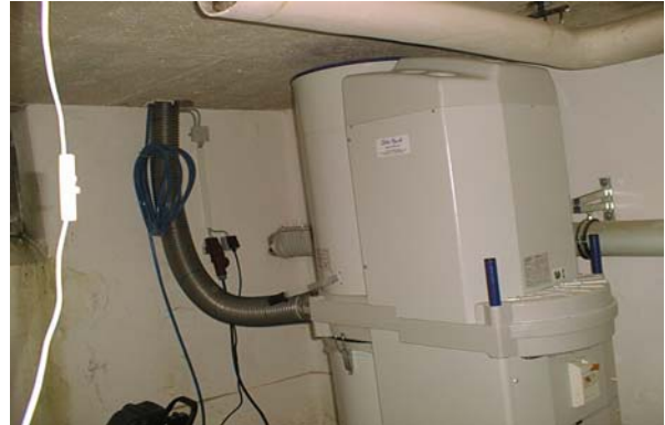
Abb. 16: Absauganlage im Keller
