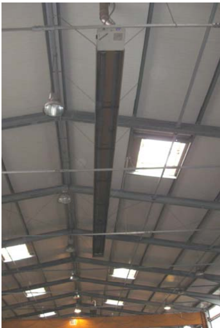
Abb. 11: Dunkelstrahler-Heizung in der Werkhalle
