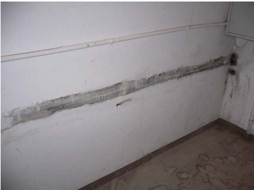
Abb. 20: Kellerniedergang ohne Rohre
