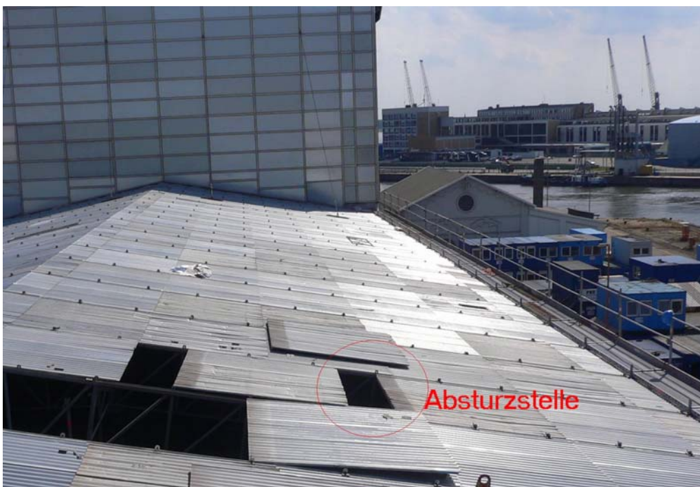
Abb. 8: Absturzstelle auf dem Dach der Wetterschutzhalle
