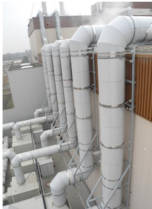
Abb. 25: Ab- und Zuluft-Leitungen zu den Biofiltern
