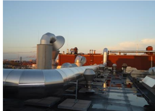
Abb. 27: Drei-Kammer-Wärmetauscher mit Abluftführung über Dach
