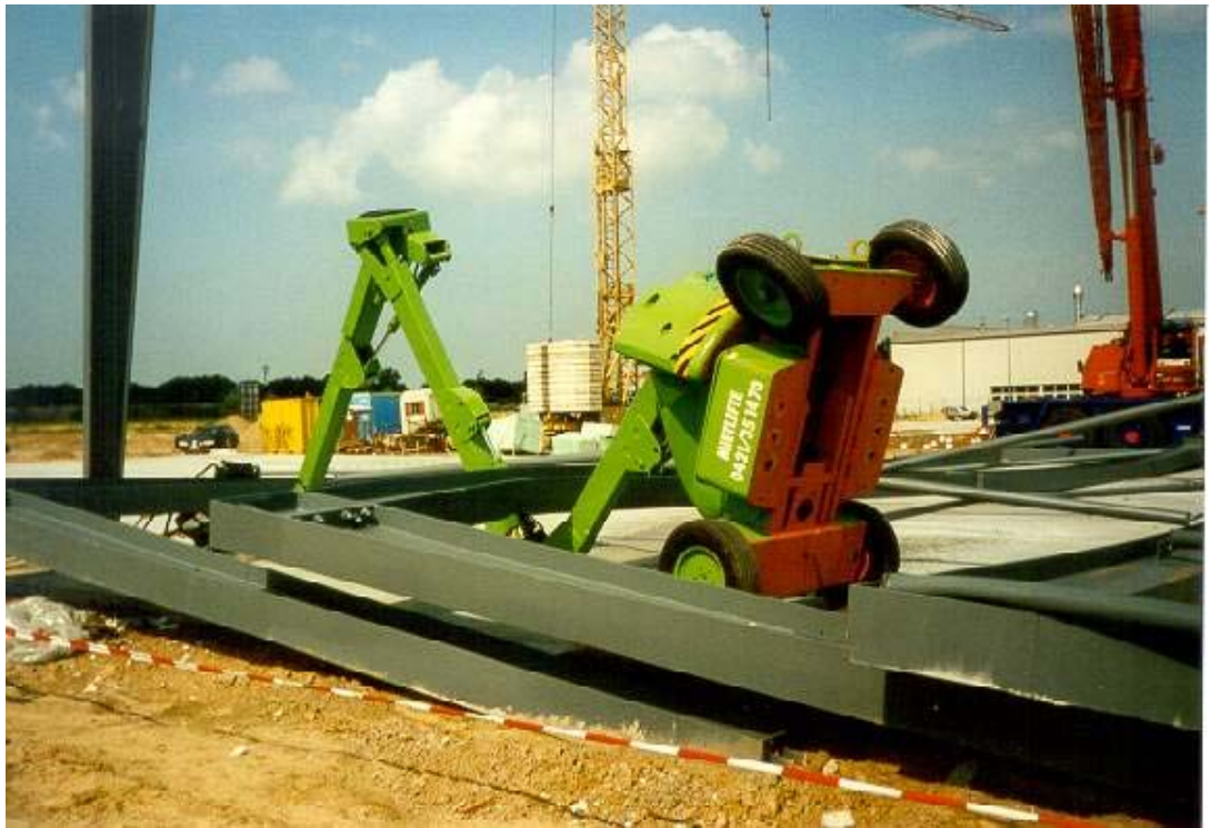
Bild: Umgestürzte Hubarbeitsbühne nach dem Unfall
