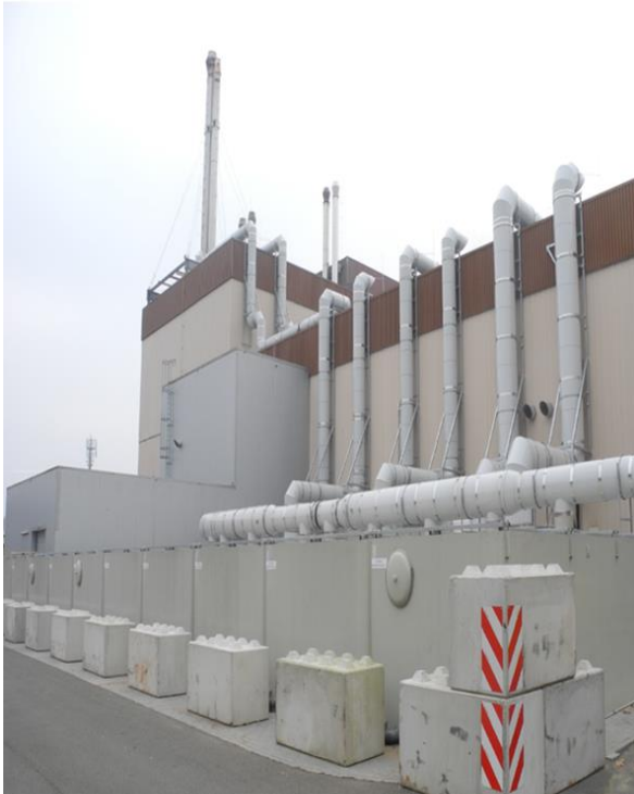
Abb. 24: Container als Biofilter
