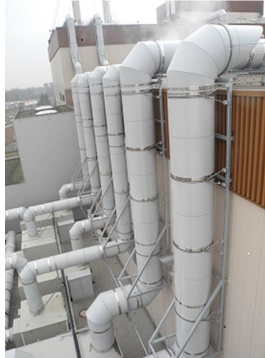
Abb. 25: Ab- und Zuluft-Leitungen zu den Biofiltern
