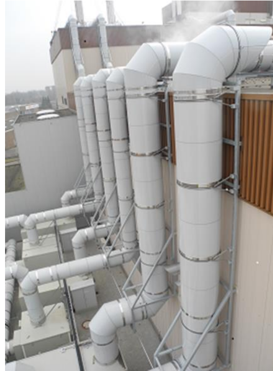
Abb. 25: Ab- und Zuluft-Leitungen zu den Biofiltern
