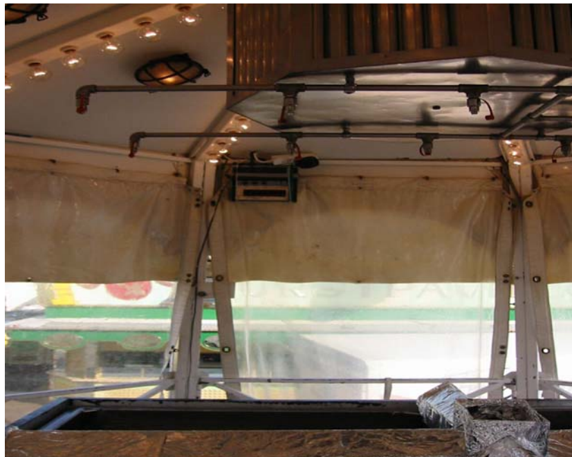
Bild: Obergeschoss der Fischbraterei mit ortsfeste Feuerlöscheinrichtung
