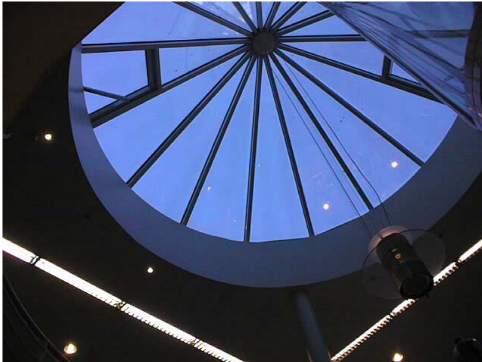
Bild 3: Glasdach mit Wärmeschutzfolie
