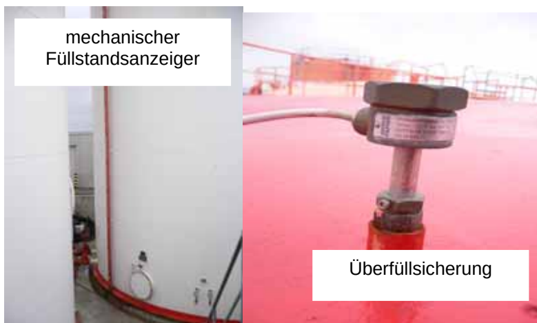
Abb. 58: Elektronische und elektrische Überfüllsicherungen
