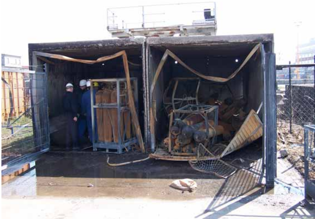
Abb. 26: Vollständig zerstörte Gasstation
