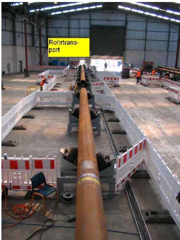
Abb. 28: Rohrschweißanlage im Schuppen
