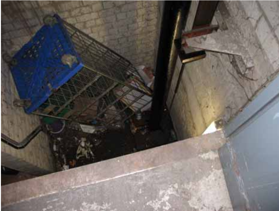
Abb. 35: Aufzugsschacht mit hinabgestürztem Rollwagen
