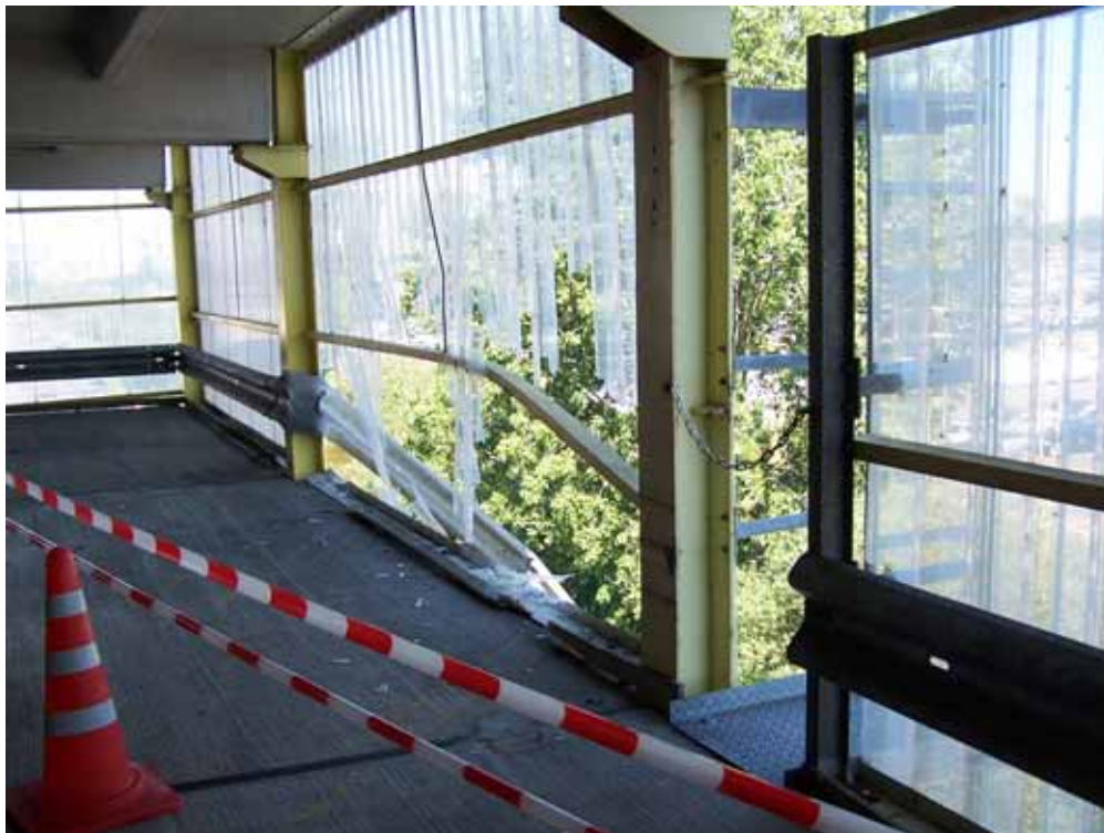
Abb. 6: Abfahrt aus dem Lagerhaus mit durchbrochener Schutzplanke
