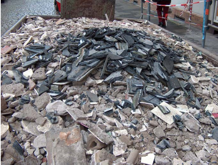
Abb. 14: Container mit Bruchstücken von Fensterbänken
