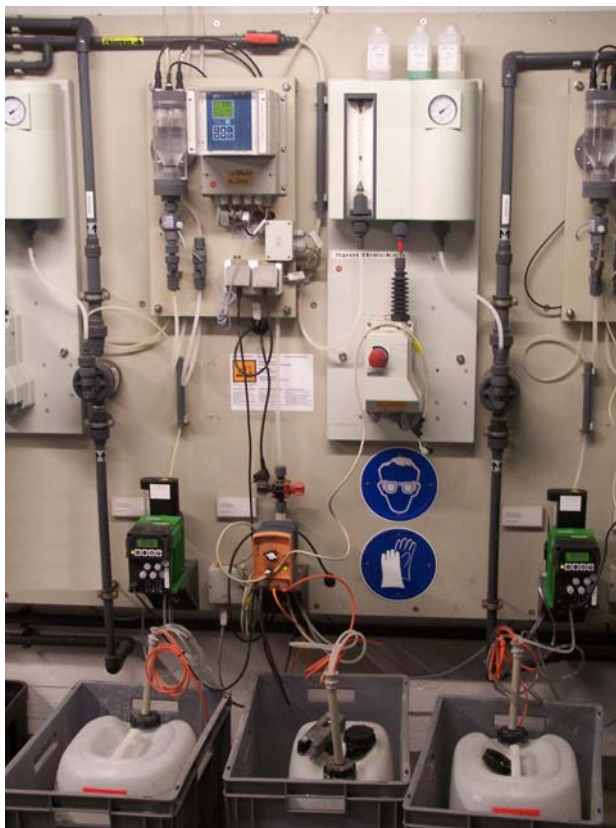
Abb. 18: Chlorgasdosierstation zur Badewasserbehandlung
