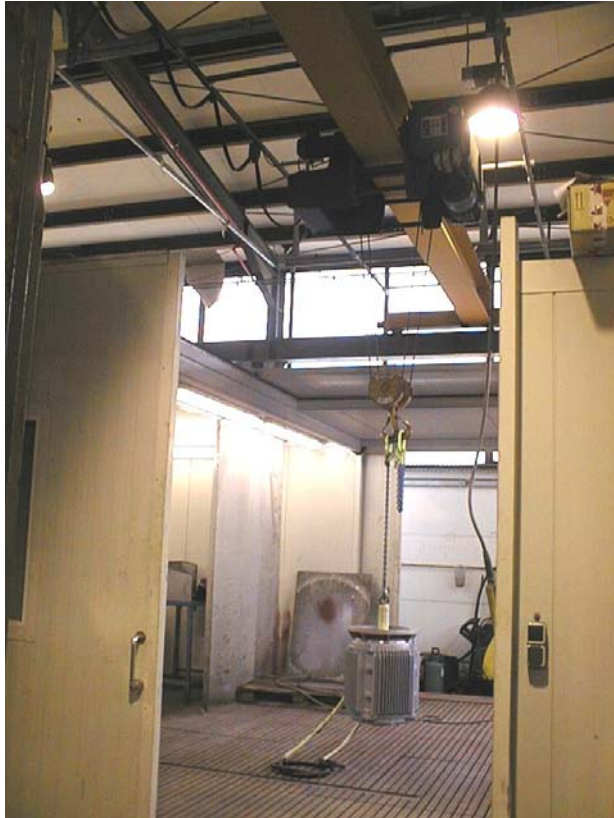
Abb. 13: Hallenkran in einer Reinigungskabine
