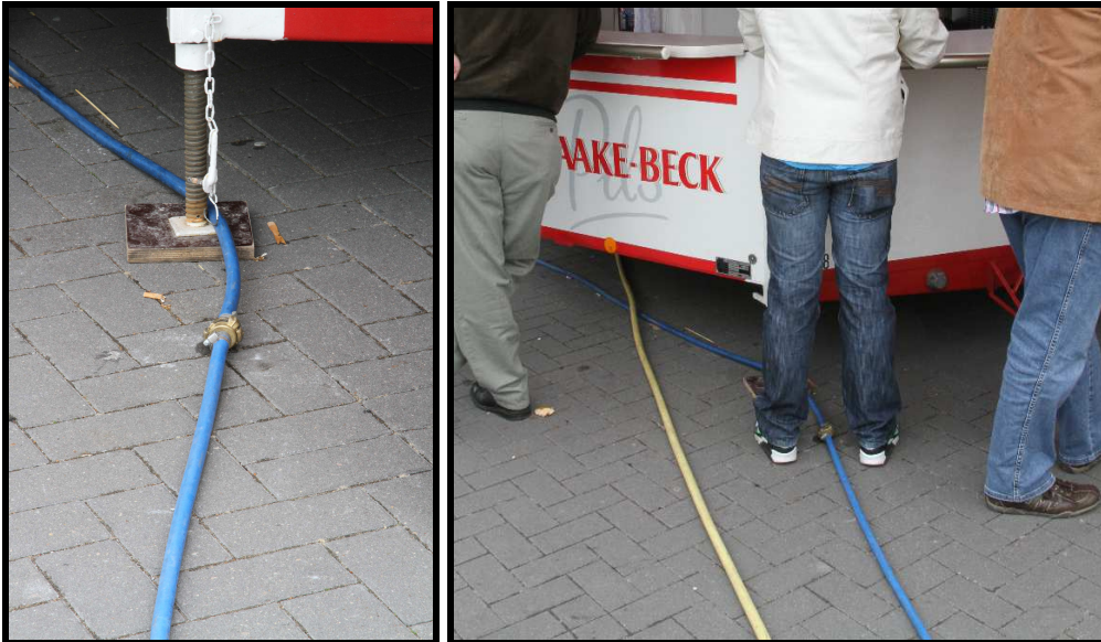
Bild 4: Ungeschützt auf dem Boden liegende Schlauchkupplung (drohender Keimeintritt), zusätzlich Unfallgefahr für Besucher.
