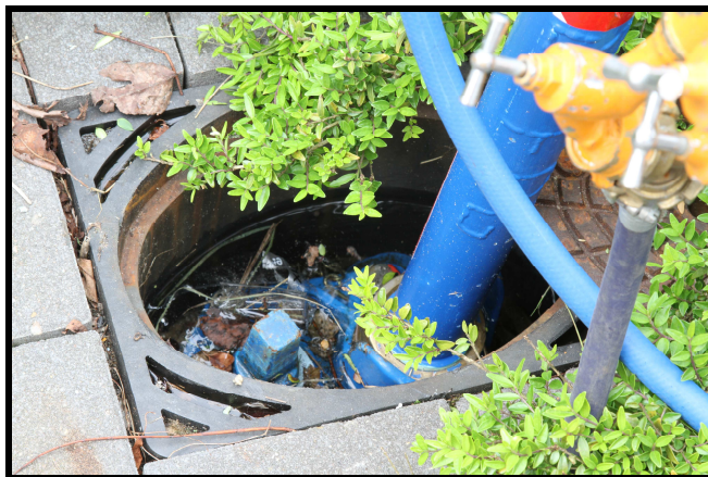
Bild 2: Hydrantenschacht steht unter Wasser und ist verschmutzt.
