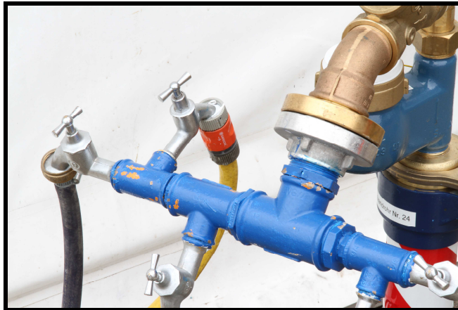
Bild 1: Zu beanstandende „Gardena – Anschlusskupplung“ an einem Hydranten zur Trinkwasserversorgung (nicht DVGW- und KTW- geprüft und deshalb nicht für Trinkwasserleitungen zugelassen).
