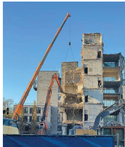
Schleuderschutz und Anprallmatte zum Schutz der angrenzenden Bereiche
